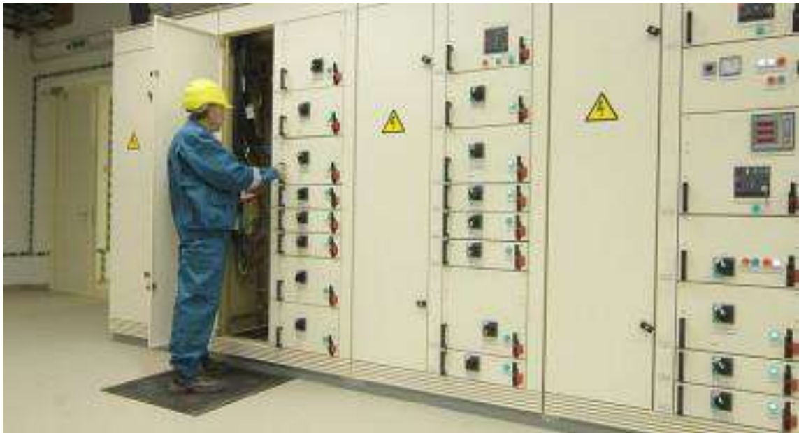
LRDS "Ilūkste" elektrosadales telpa
