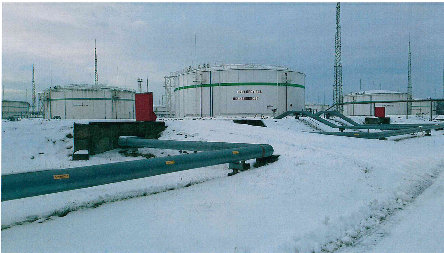
1. Foto attēls Ugunsdzēsības ūdens cauruļvada (DN250) posms
