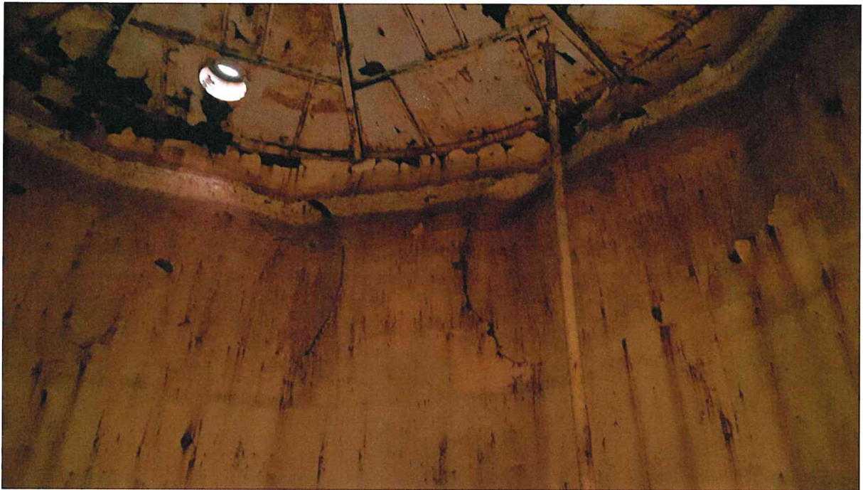
3. foto attēls Rezervuāra 103-2 deformētā siena (josla) skats no iekšpusēs
