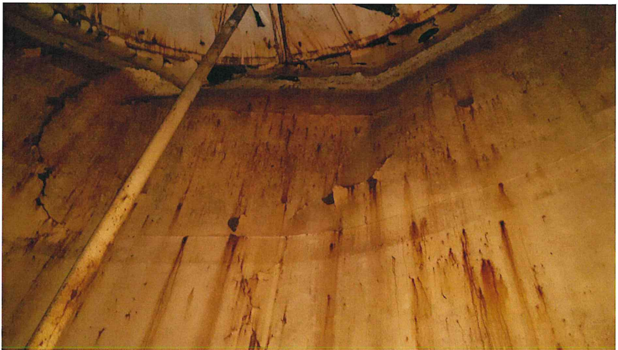
4. foto attēls Rezervuāra 103-2 deformētā siena (josla) skats no iekšpusēs
