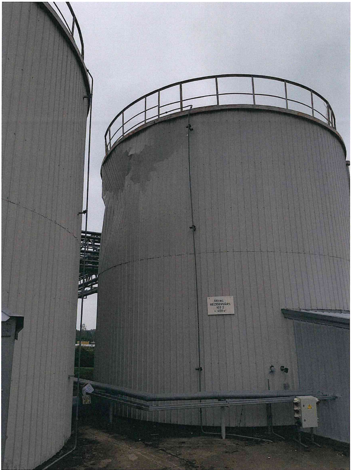
2. foto attēls Rezervuāra Nr.103-2 deformētā ārsiena (profilētās tērauda loksnes)
