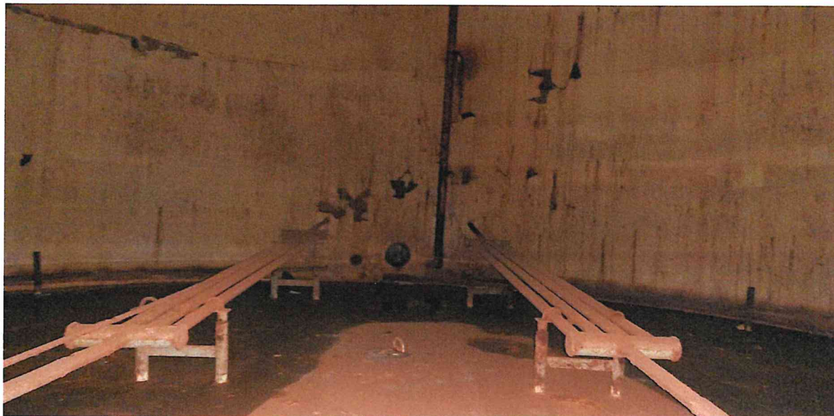
5. foto attēls Rezervuāra ūdens apsildes reģistri
